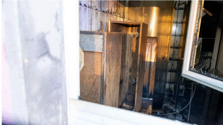
Beschädigte Schränke: Blick ins Innere des ehemaligen VfL-Clubheims.
